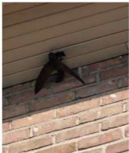
Gierzwaluwsteen weggewerkt in dakrand
