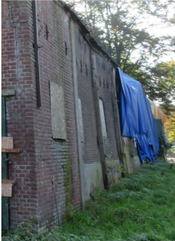
De noordwestgevel van de stal helt vrij sterk achterover.
