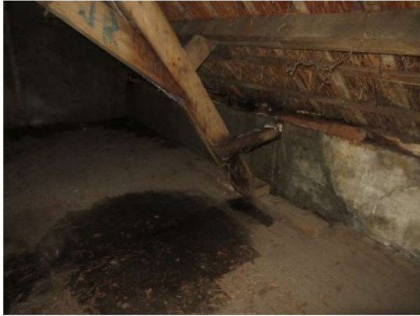
Spant, blokkeel en muurplaat hier sterk aangetast
