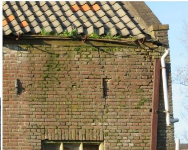
Scheurvorming, slecht voegwerk en anker in zuidoostgevel
