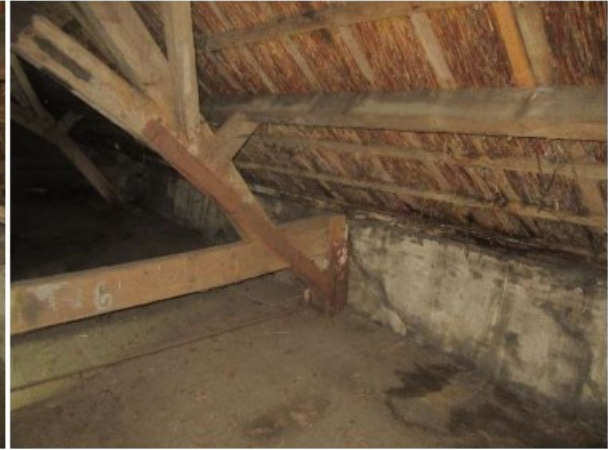
Spant aangepast, stalen trekstang. Muurplaat rot
