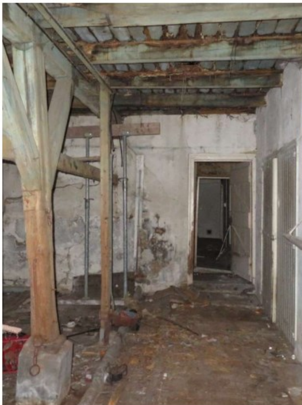
Balklaag en zoldering aangetast
