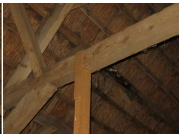
Plaatselijke aantasting gording, t.p.v. lekkage
