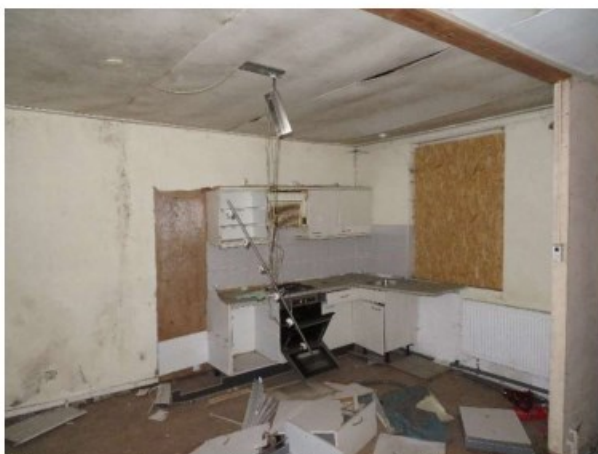
Afwerkingen interieur beschadigd en beschimmeld
