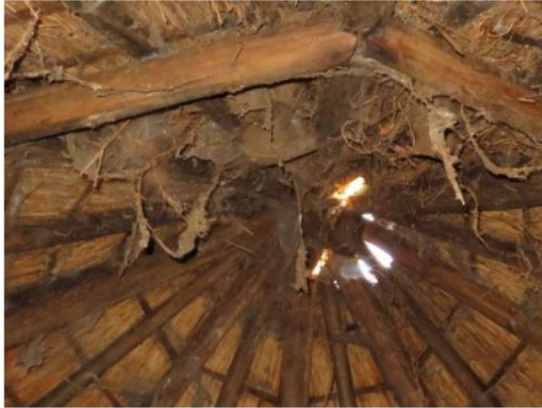
Dak karnhuisje lekt, constructies aangetast door vocht
