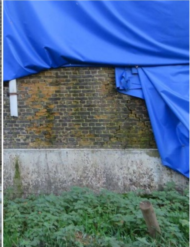
Scheuren en verweerde stenen in noordwestgevel stal
