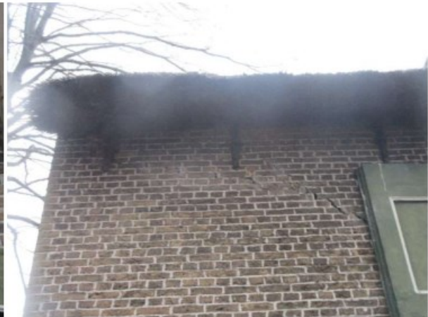
Muurwerk hoek zuidoostgevel /voorgevel ontzet
