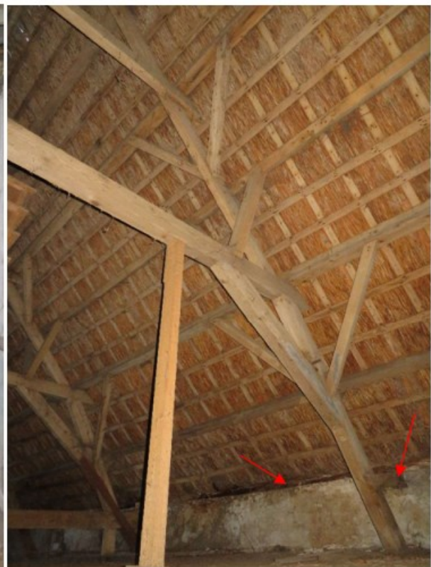
Muurplaat en blokkeel aangetast, spant en gordingen goed
