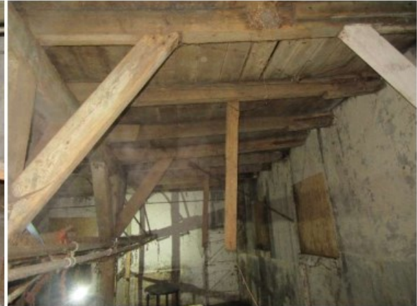
Balklaag zoldering stal sterk verzakt
