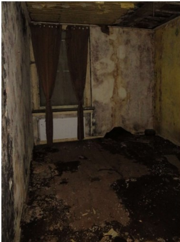
Vloer woonhuis verzakt en aangetast
