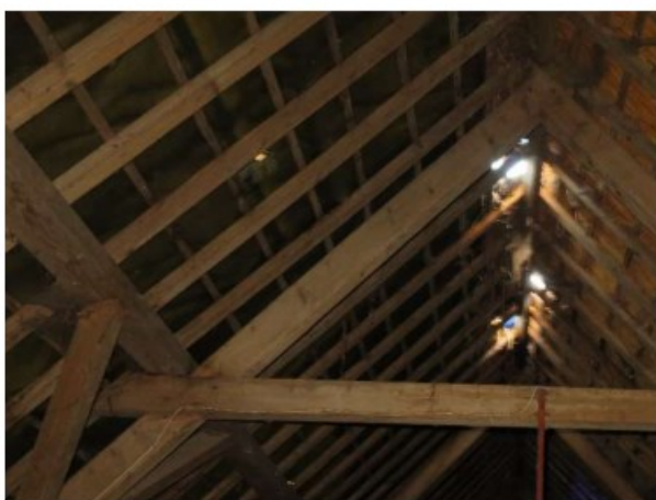
Lekkage nok, aantasting nokgording
