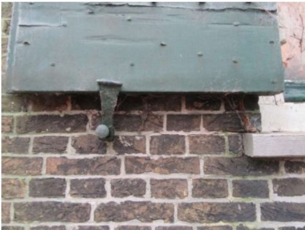
Scheur door corrosie van de luikwartel
