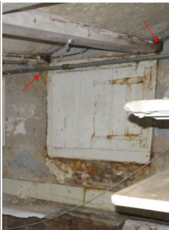
Kopen houten balklaag boven kelder aangetast
