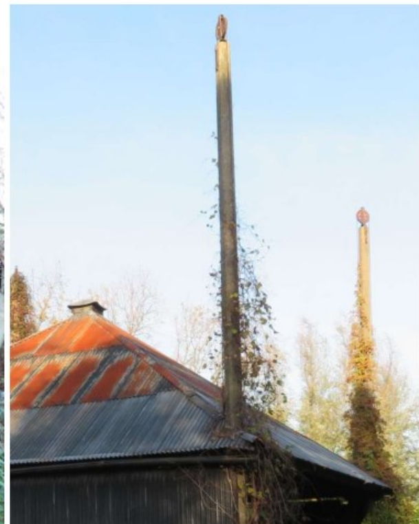
Roeden hooiberg overwoekerd; dakplaten gecorrodeerd
