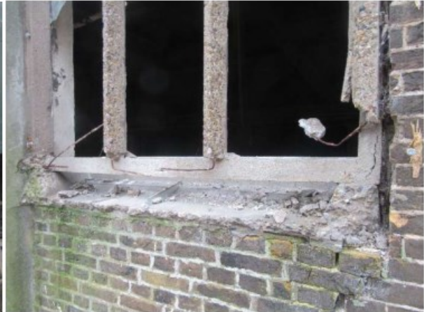
Schade aan het beton van de stalramen.
