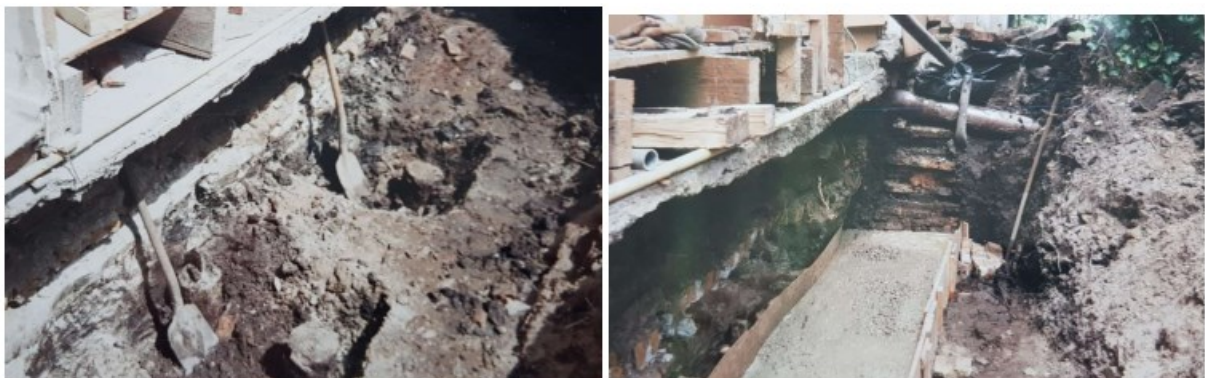
Uitvoering funderingsherstel in de jaren '90: links de vrijgemaakte palen, rechts de betonsloof (foto's fam. Reijm)
