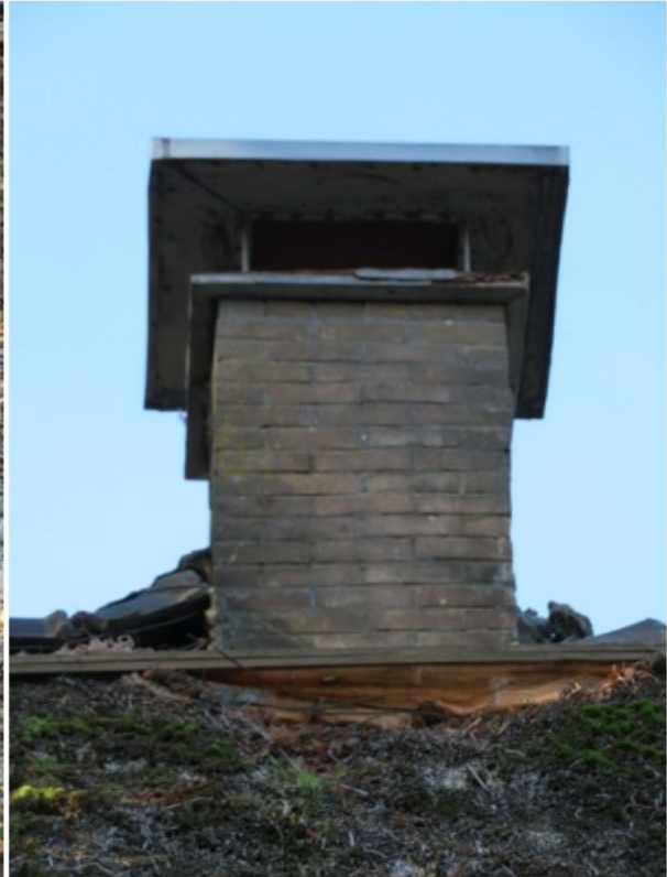
Schoorsteen komt omhoog t.o.v. dak, kap ingerot
