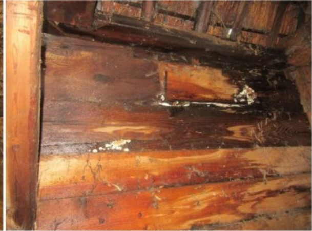
Gevelbeplanking aangetast door houtrot en zwam
