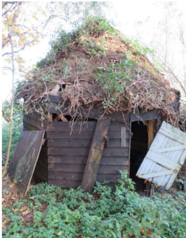
Karnhuisje overwoekerd, verzakt; planken/deuren los en rot
