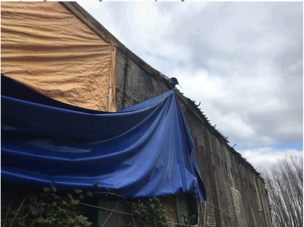
Foto 3, gevel buikt behoorlijk uit naar buiten
