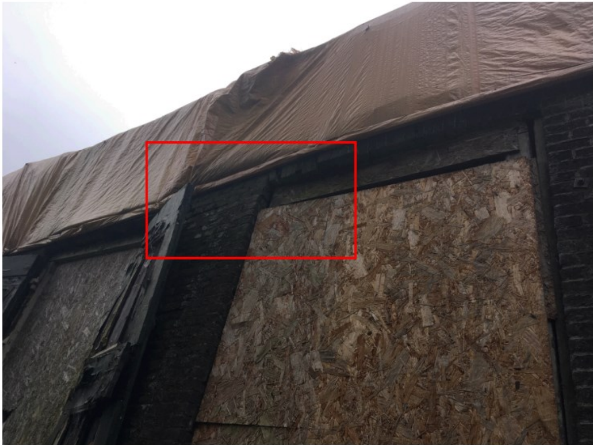
Foto 4, bovenzijde gevel staat geheel los
