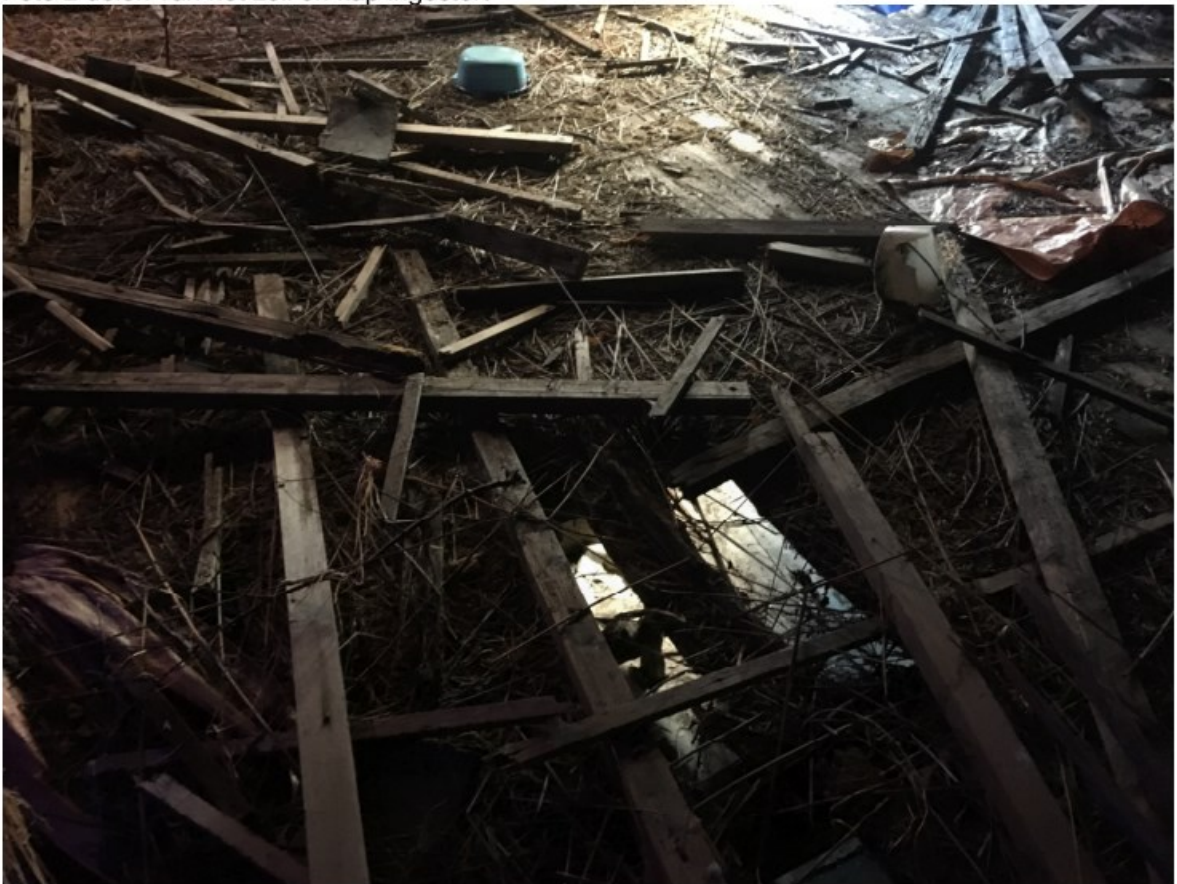
Foto 3 verdiepingvloer in zeer slechte staat
