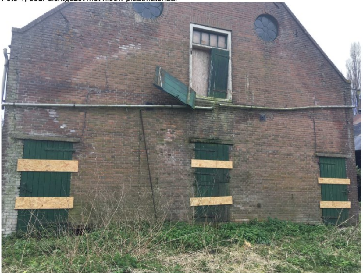
Foto 5, deuren achtergevel dichtgeschroefd
