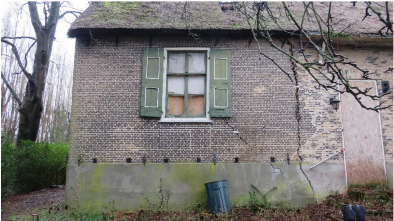
Afbeelding 2.1: schade metselwerk zuidoostgevel
