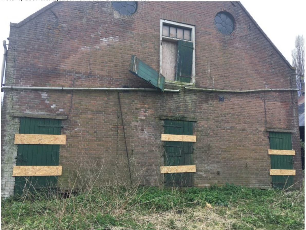
Foto 5, deuren achtergevel dichtgeschroefd
