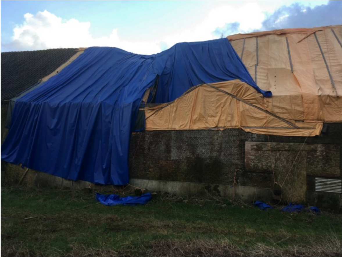
Foto 2 delen van het zeil en kap ingestort
