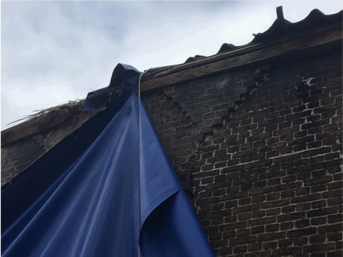
Foto 2, delen gevel onder de nog resterende muurplaat losgescheurd.
