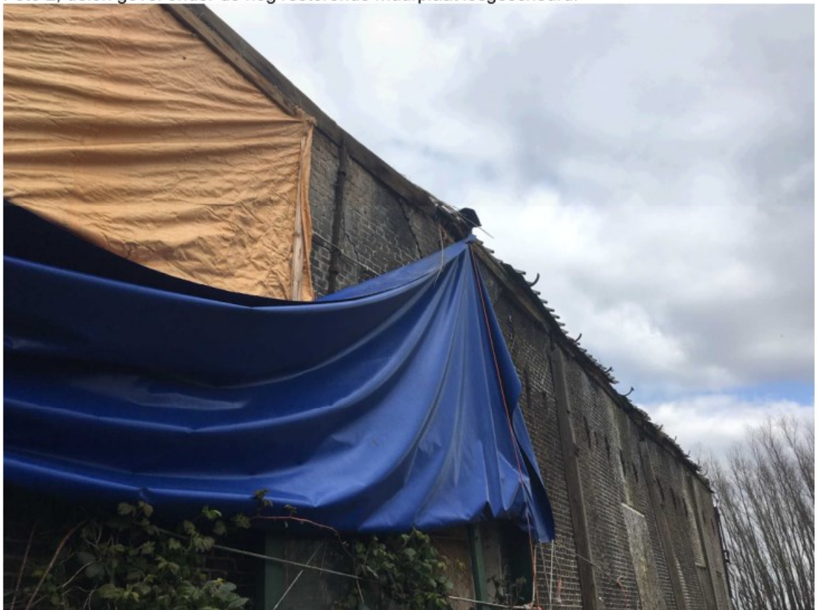
Foto 3, gevel buikt behoorlijk uit naar buiten
