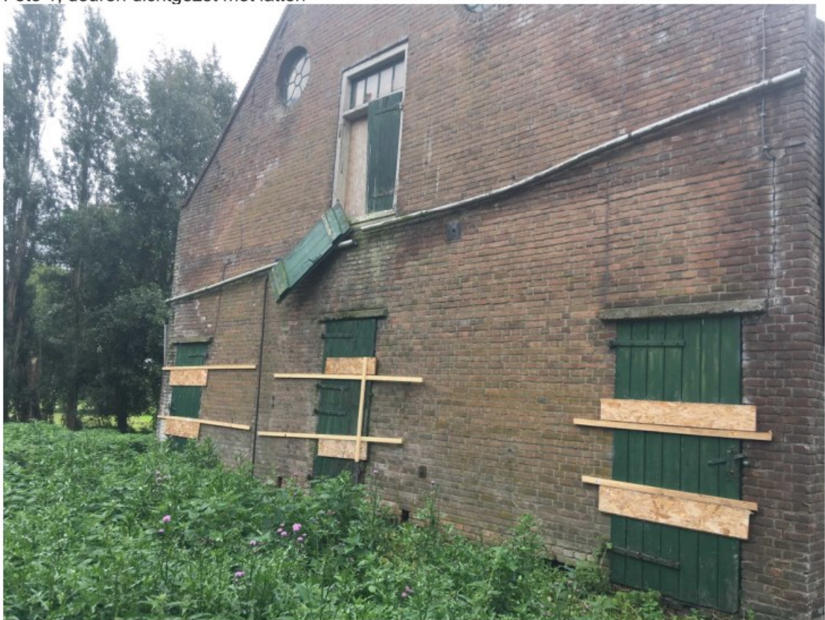
Foto 2, luik hangt los (verdieping), dreig naar beneden te komen.
