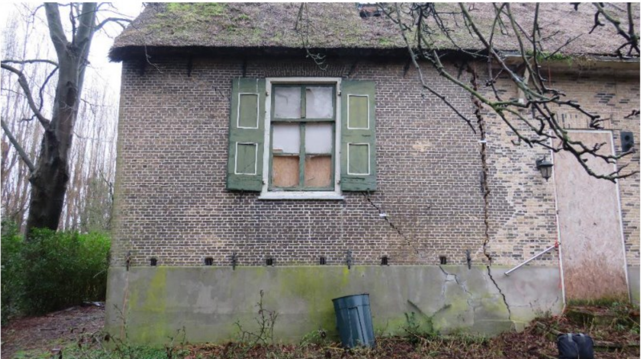
Afbeelding 2.1: schade metselwerk zuidoostgevel
