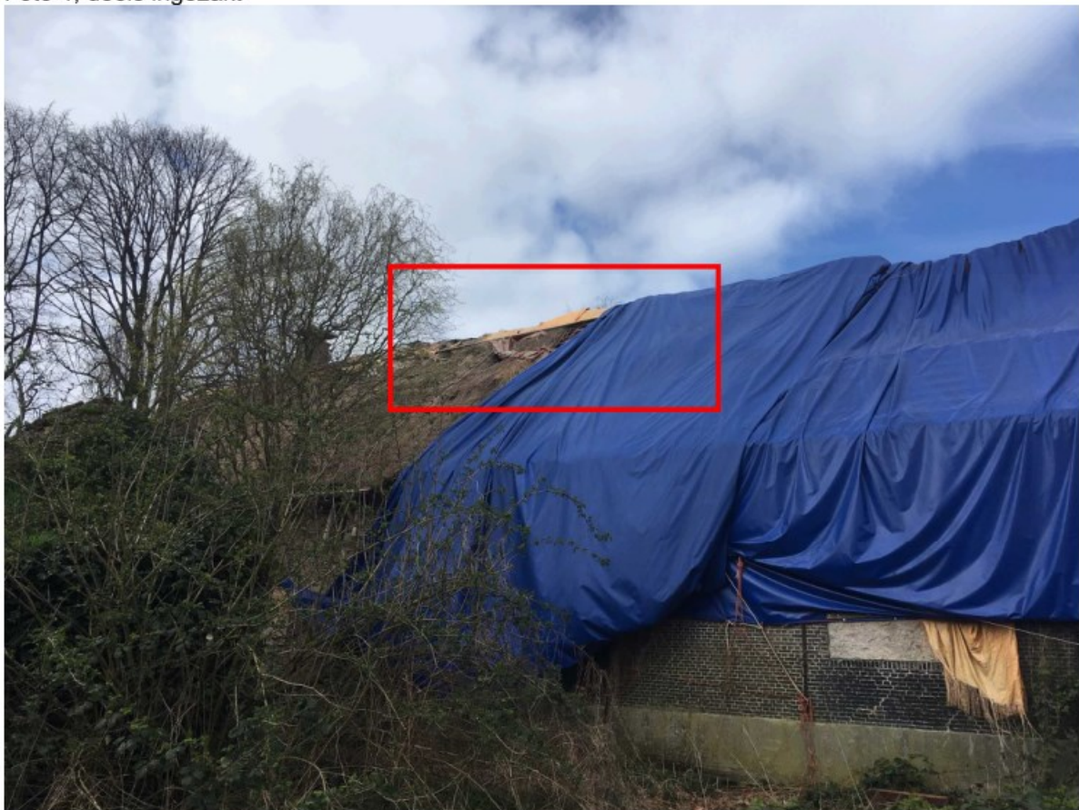
Foto 5, rechter dakvlak vanaf de weg gezien, dak ligt deels open
