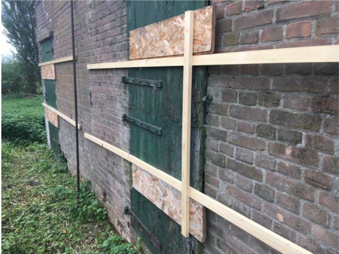
Foto 1, deuren dichtgezet met latten
