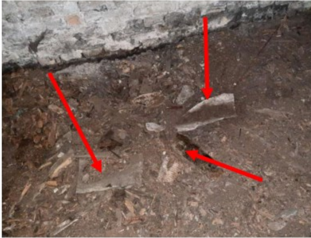
MM02 stukjes golfplaat op vloer schuur (deels)
