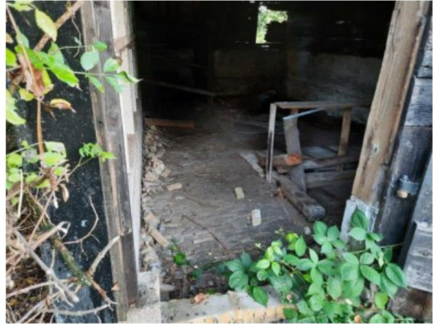
MM02 stukjes golfplaat op vloer schuur (deels)
