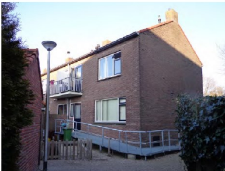
Huidige situatie waarbij woningen moeilijk toegankelijk zijn door verzakking. (Bron: Stedenbouwkundig plan BDP Rotterdam)
