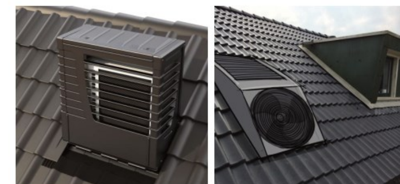
Buitenunits geïntegreerd in het bouwvolume
