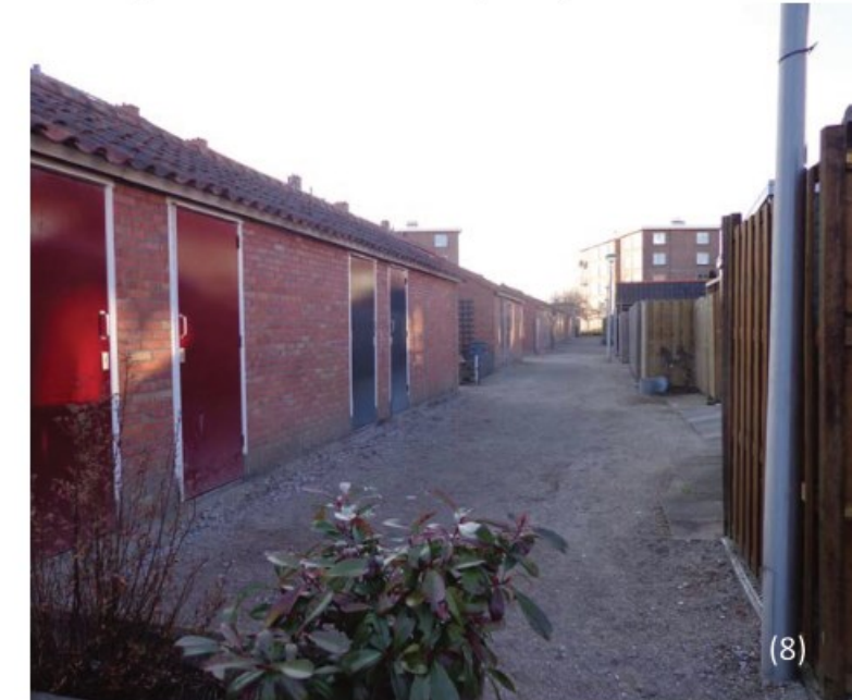
De achterpaden zijn verzakt en hebben door de materiaalkeuze een kale, onaantrekkelijke uitstraling. Wegens onduidelijke verantwoordelijkheden en rechten verrommelen de achterpaden.
