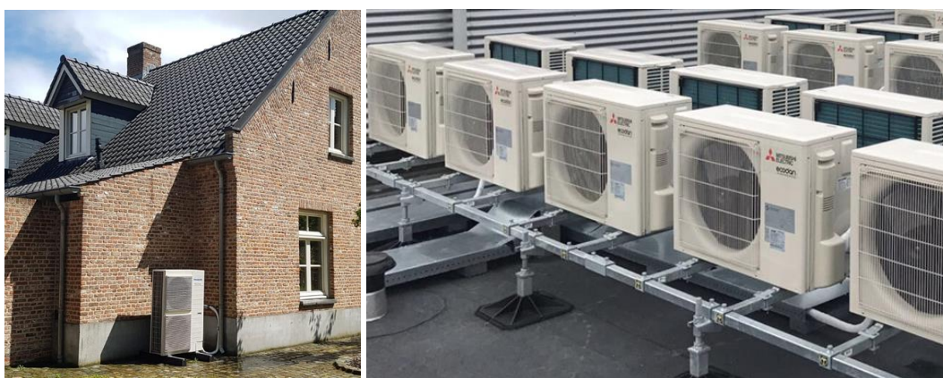
Figuur 6.4 | Voorbeeld buitenunit lucht-/waterwarmtepomp, enkele woning (links) of meerdere appartementen (rechts).
