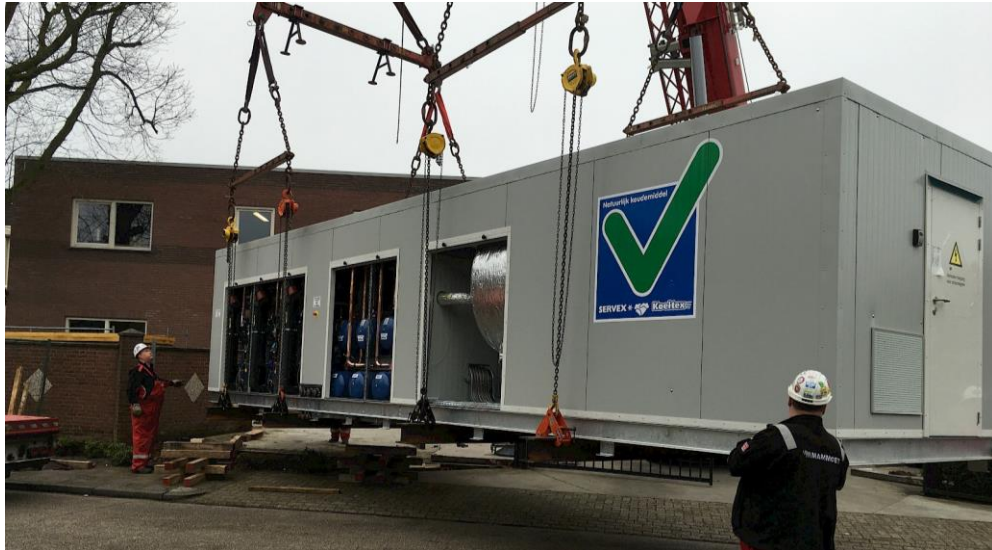
Figuur 6.11 | Plaatsing van een collectieve lucht-/waterwarmtepomp.
