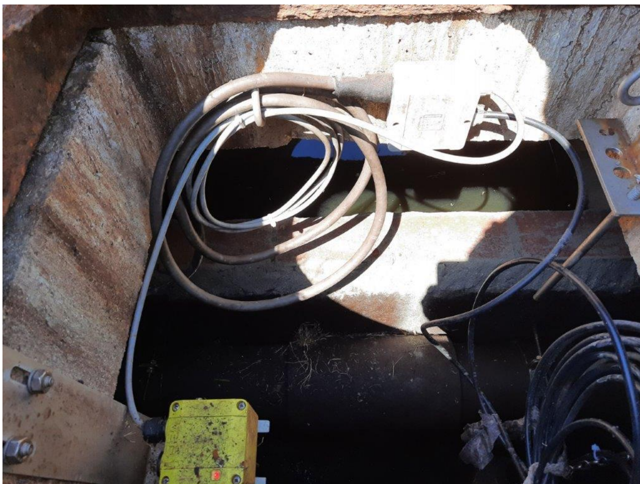
Figuur 8: Door waterniveaus te meten krijgen we inzicht in het ledigings- en vullingsgedrag van de riolering
