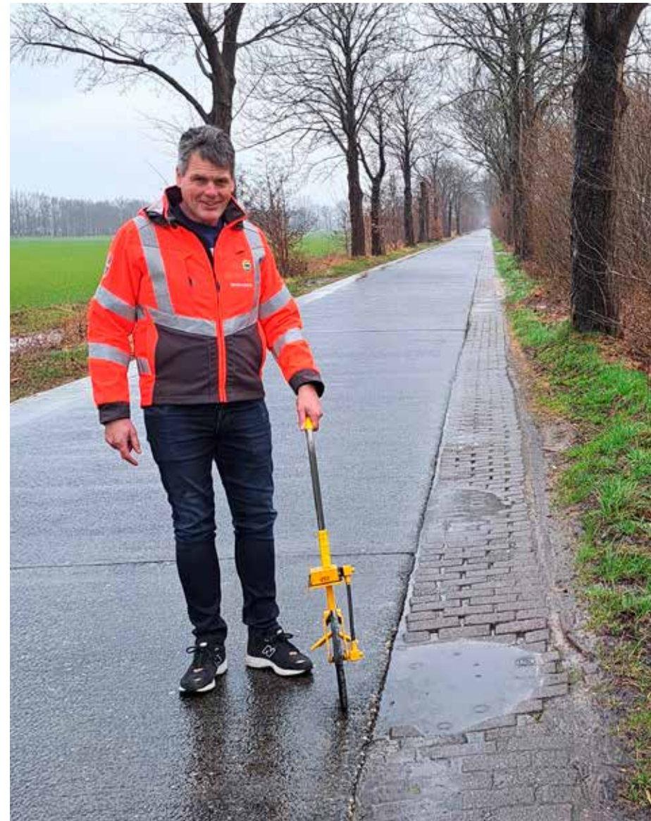
Jan Dijkstra inspecteert de berm schade
