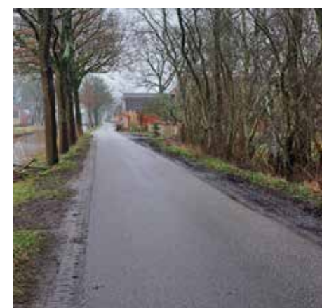
Aan de Tjalling Harkeswei is de berm schade duidelijk zichtbaar.
