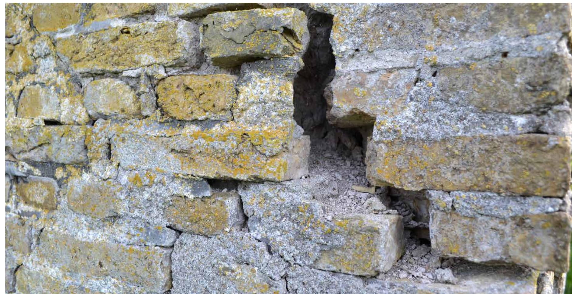
Funderingsschade schade huis bij rivier de Linde (2020; foto Rob de Wind)
