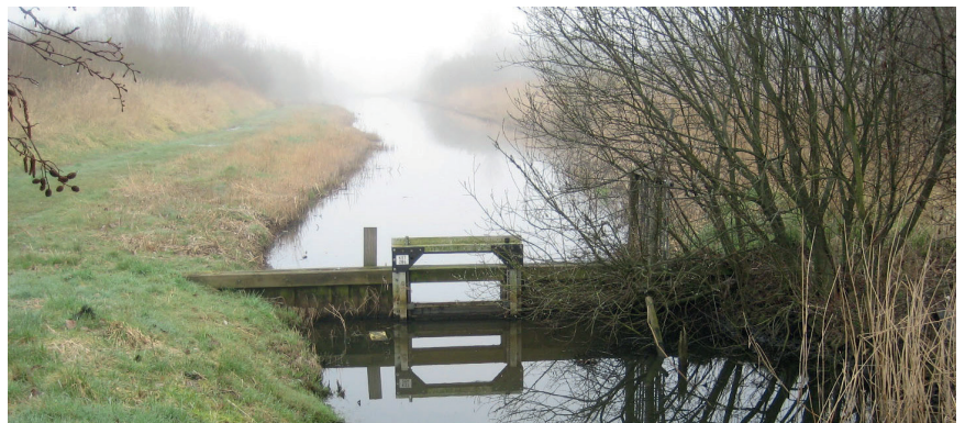
In het traject ligt een aantal oude kleine stuwtjes die vervangen worden. Met behulp van stuwtjes regelen we het waterpeil.
