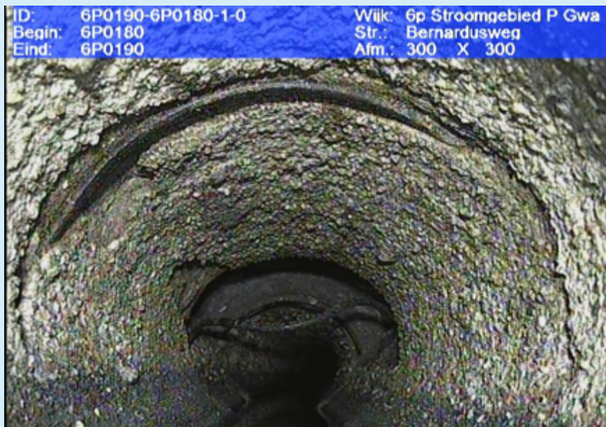
Foto: Inspectiebeelden rioolinspectie (Bernardusweg – Lage Mierde)
