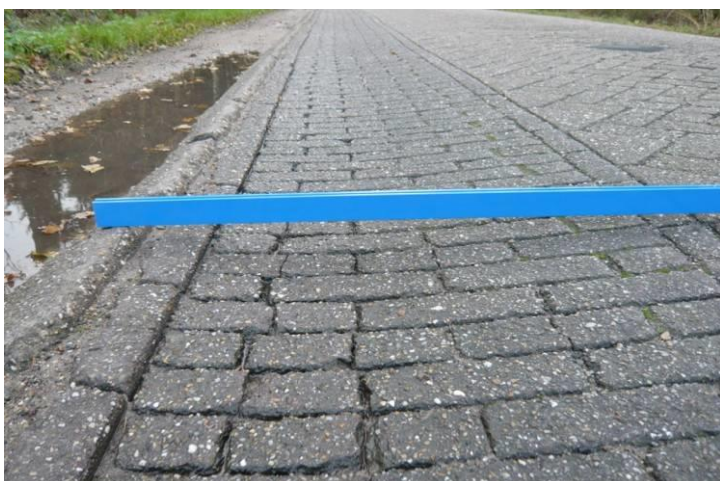
Figuur 5 Schadebeeld ernstige spoorvorming op elementenverharding
