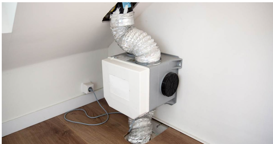
Een mechanische ventilatiebox, deze wordt dan vervangen. Foto: Milieu Centraal
