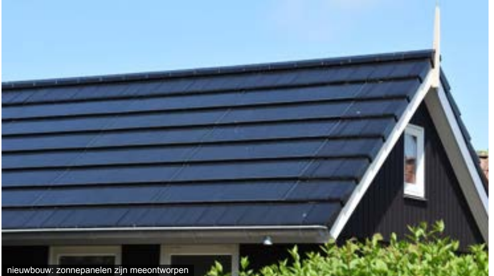
nieuwbouw: zonnepanelen zijn meeontworpen
