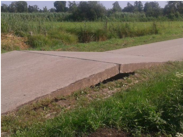
Figuur 2.5 Betonplaten Holtrustweg en Postweg zetten uit bij hitte (2014). Bron: De Stentor
