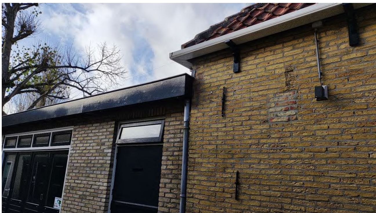
Dichtgezette sparring met andere baksteen. Dit lijkt dezelfde als binnenblad tussenmuur.
