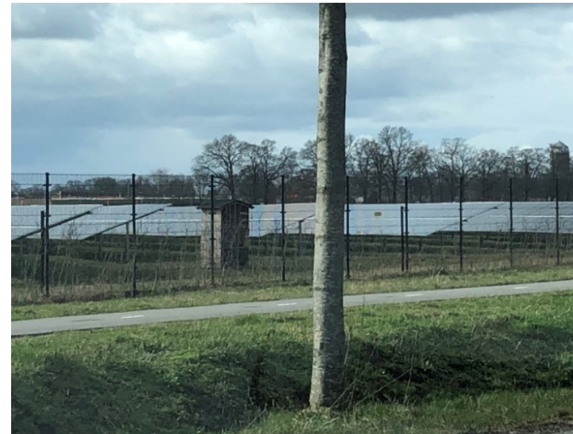
Figuur 2.2 Bestaand zonneveld Oosterweilanden bij Vriezenveen
