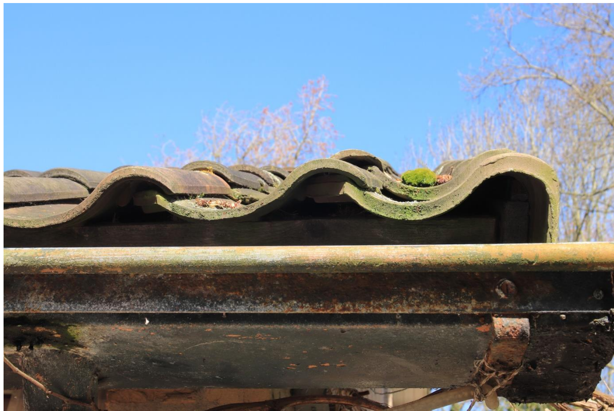
Foto 2: De openingen onder de dakpannen zijn erg groot. Onder de dakpannen die getild zijn tijdens het veldwerk zijn geen uitwerpselen gevonden van vleermuizen.
