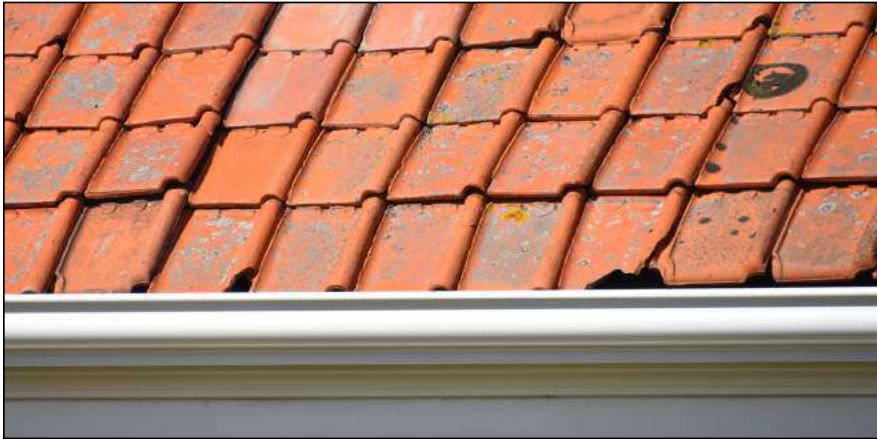
Figuur: detailopname van het dak van het woonhuis. Bij de dakgoot zijn openingen aanwezig waar huismus en vogels zonder jaarrond beschermd nest in kunnen broeden.
