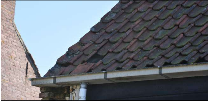
Figuur: het dak van de schuur heeft op diverse plaatsen openingen door losliggende of scheefgezakte dakpannen. Hierdoor kunnen vleermuizen, vogels zonder jaarrond beschermd nest en huismussen ruimtes in het dak bereiken, waar ze verblijfplaatsen kunnen hebben of kunnen broeden
