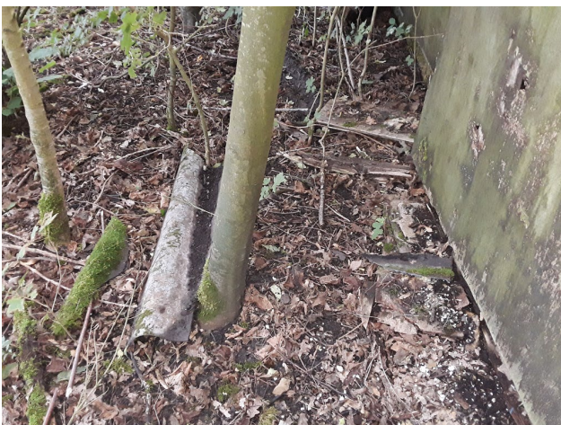
Zijgevel: restanten golfplaat
