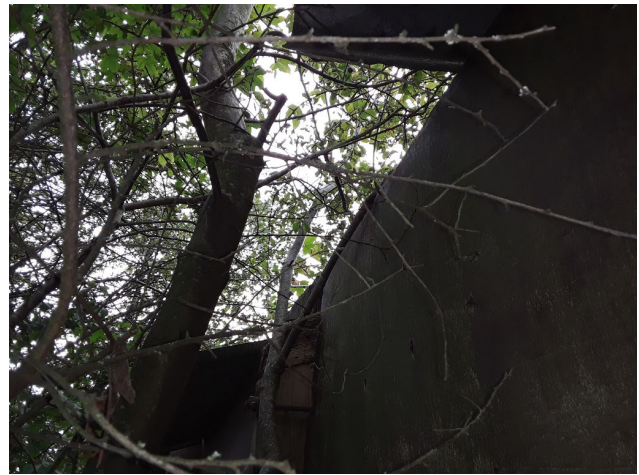
Het dak is plaatselijk zwaar beschadigd.
