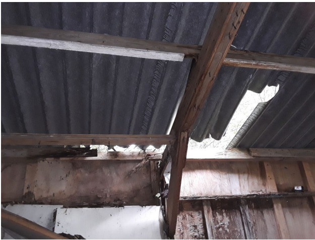
Het dak is plaatselijk zwaar beschadigd.
