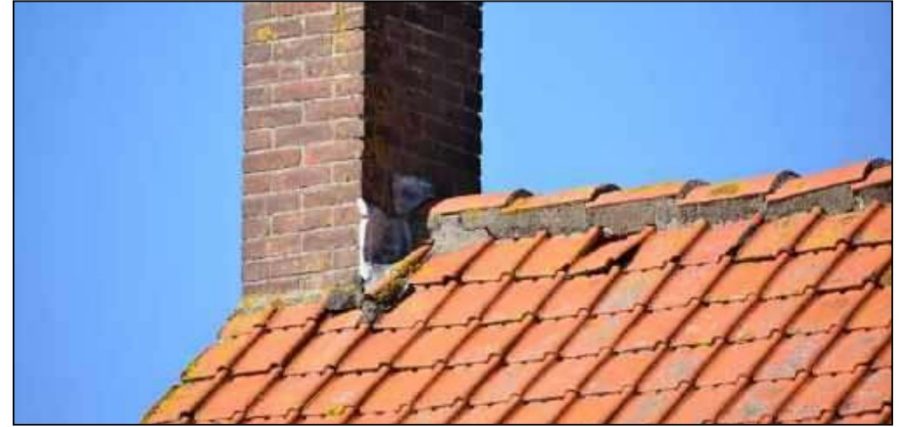
Figuur: op het dak van het woonhuis zijn losliggende of scheefgezakte dakpannen aanwezig waardoor vleurmuizen, vogels zonder jaarrond beschermd nest en huismus ruimtes in het dak kunnen bereiken.
