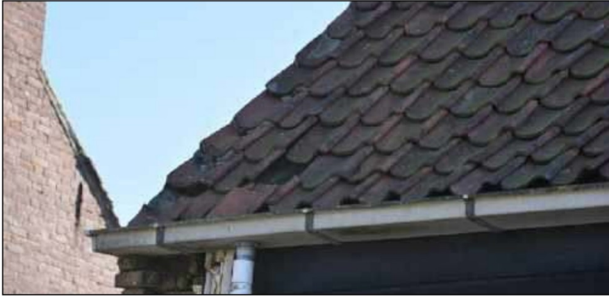
Figuur: het dak van de schuur heeft op diverse plaatsen openingen door losliggende of scheefgezakte dakpannen. Hierdoor kunnen vleurmuizen, vogels zonder jaarrond beschermd nest en huismussen ruimtes in het dak bereiken, waar ze verblijfplaatsen kunnen hebben of kunnen broeden
