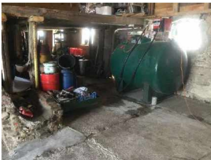
Foto 5 Huidige BG-dieseltank en olieopslag in de historische schuur
