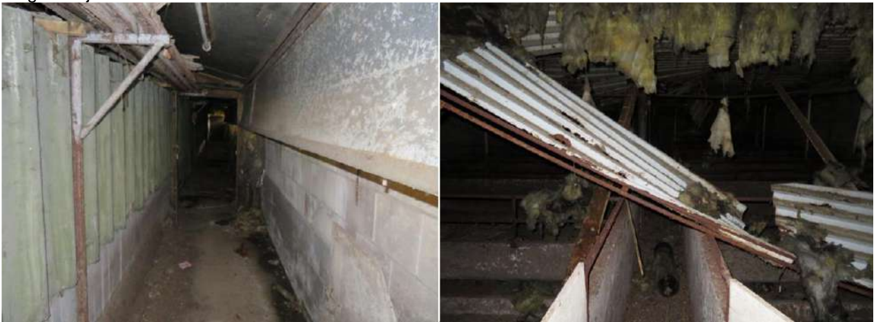
Afbeelding 10 en 11: Gang in de varkensstal om naar de hokken te komen (links de buitenkant van golfplaat). Geheel vergane binnenkant van de stallen.
