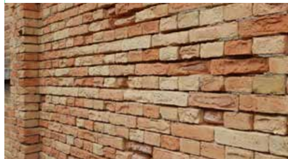
Slechte staat metselwerk
