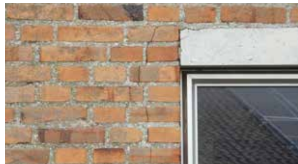
Scheuren in metselwerk
