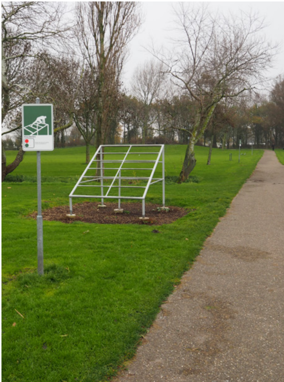
het fitnessparcours kent achterstallig onderhoud
