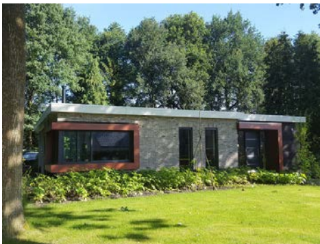
niet toegestaan eenlaags plat dak
