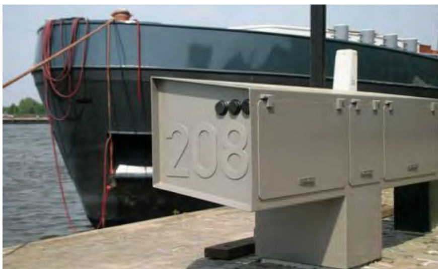
Referentie: zorgvuldig vormgegeven inrichtingselementen zoals walstroomkasten t.b.v. van de havens dragen bij aan de beeldkwaliteit van de kades.
