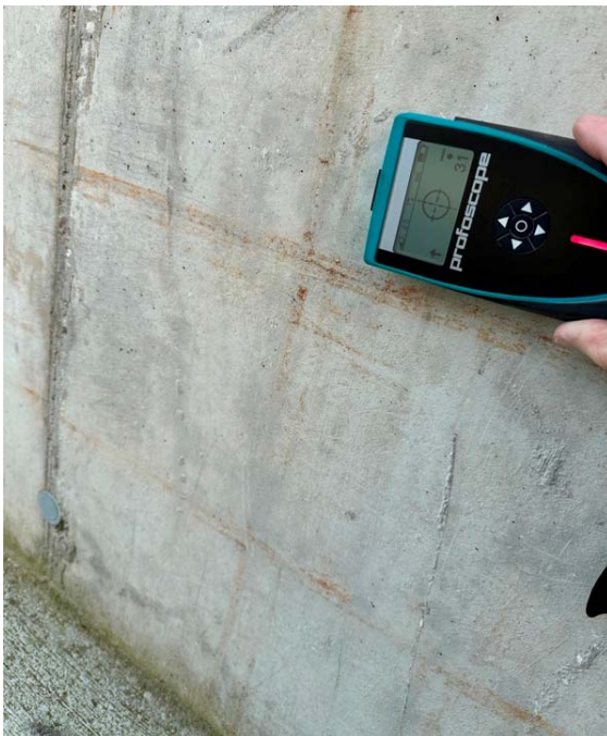
figuur 9 Corrosiesporen op wand hellingbaan.
