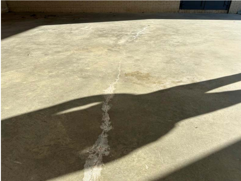
figuur 8: Scheur in vloer fietsenkelder met kalkuitbloei
