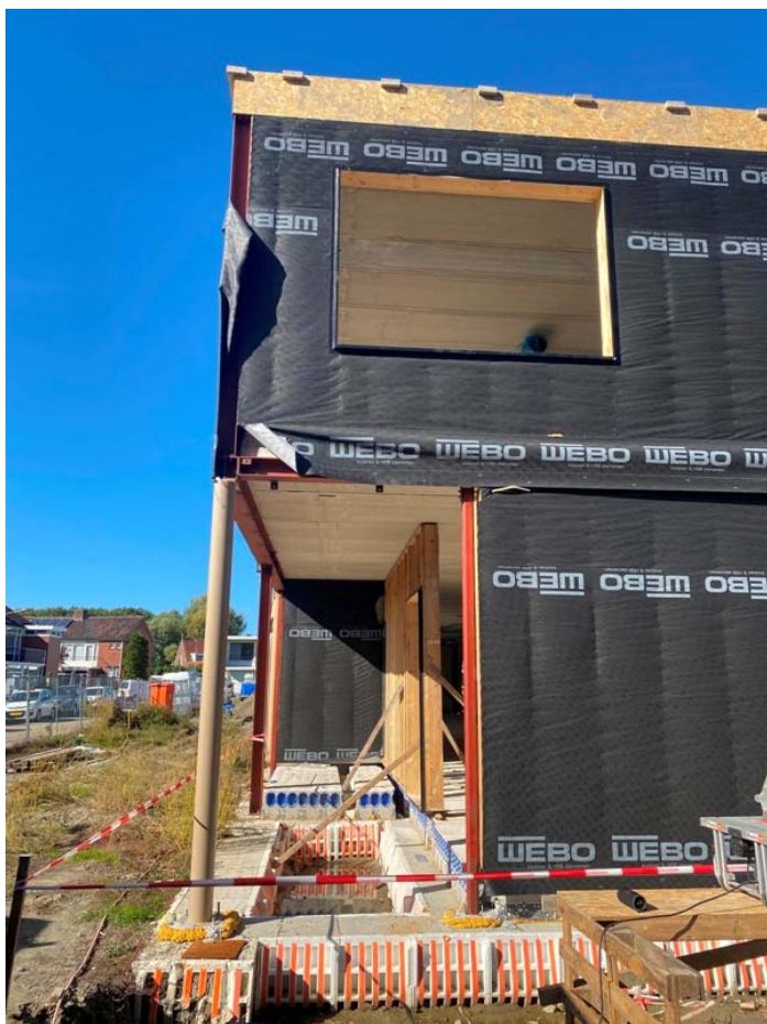
figuur 12 Foto van de uitvoering, waarop (zwarte) waterkerende laag is te zien.
