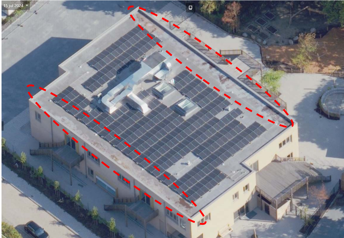
figuur 11: Luchtfoto van het schoolgebouw d.d. 15 juli 2024 (bron: Cyclomedia) met markering van vervuiling
