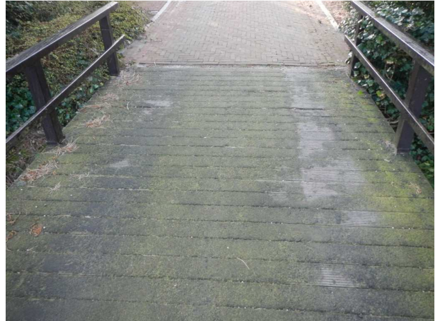
Matige uitstraling ten gevolge van kale plekken in de slijtlaag. (tevens mogelijk veiligheidsrisico i.v.m. stroefheid)
