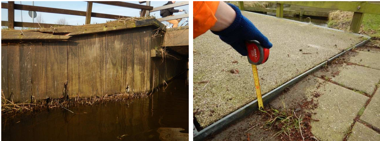
Kans op bezwijken damwand bij boven belasting a.g.v. houtrot Struikelgevaar door verzakking tegelwerk
