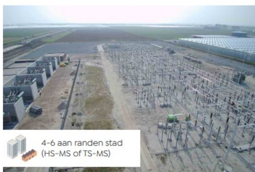
HS-MS station (van 110-150 naar 3-23 kV)
