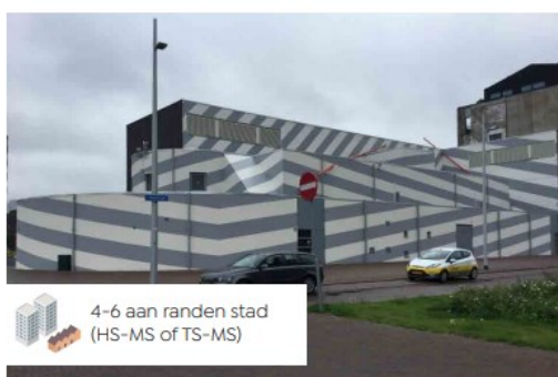
TS-MS station (van 25-66 naar 3-23 kV)
