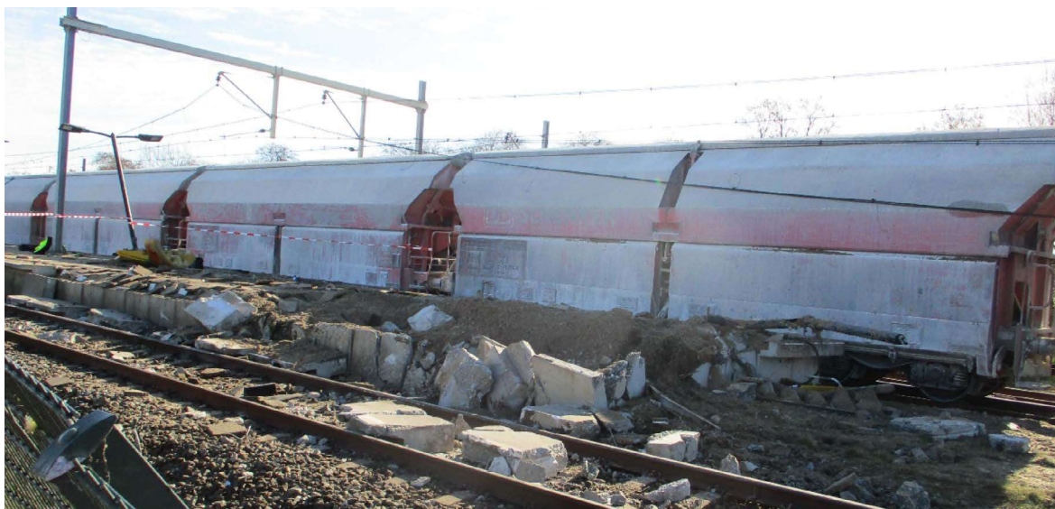
▲ Figuur 50: Foto van schade aan perron. (bron: ProRail)
