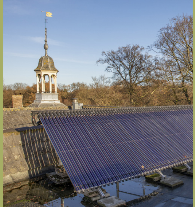
Vacuümbuiscollectoren voor warmtewinning
