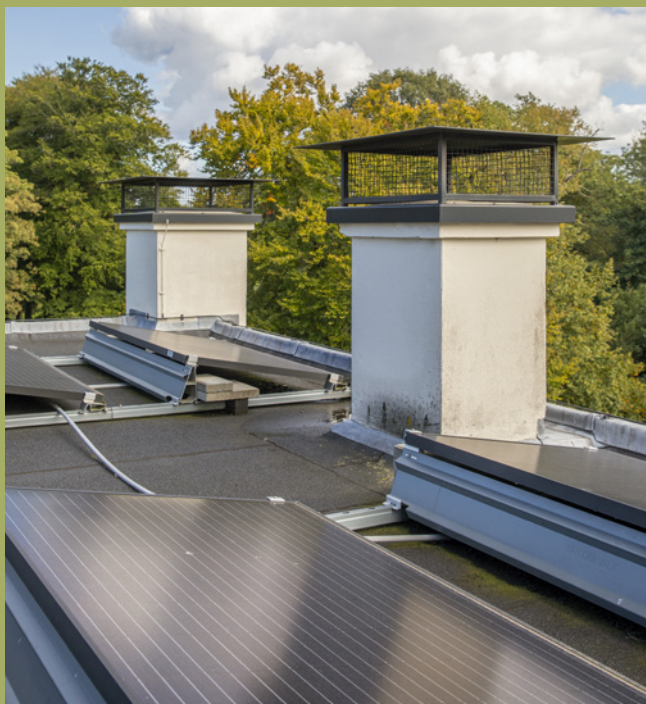
Zonnepanelen voor stroomopwekking
