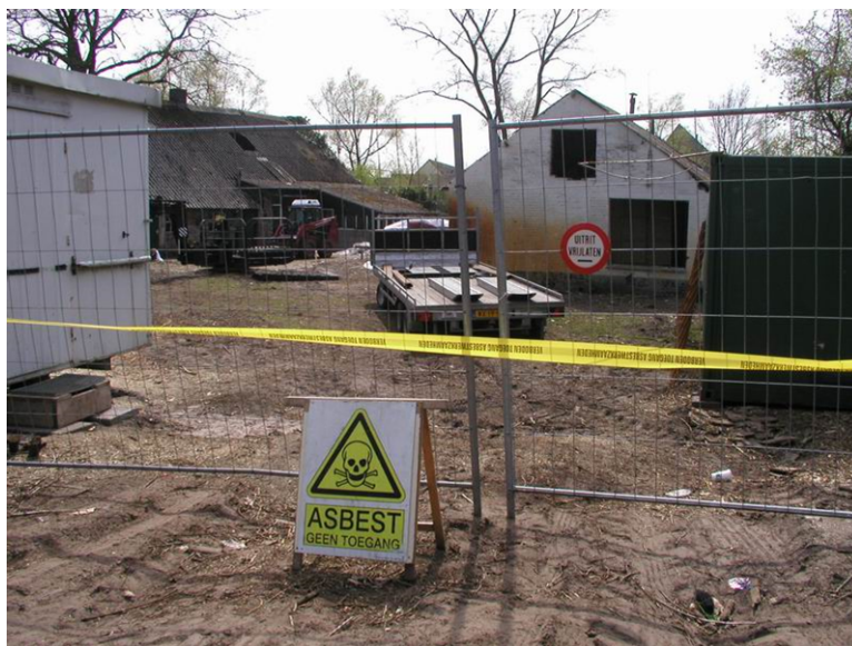
Figuur 17: Afscherming van een asbestverdachte locatie
