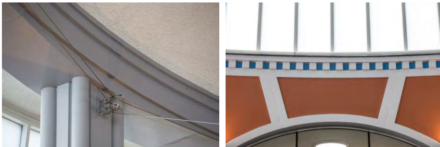
Aansluiting van de kolommen die met profielstukken zijn afgetimmerd op de ringbalk. Rechts de elementen die door de architect timpanen werden genoemd.
