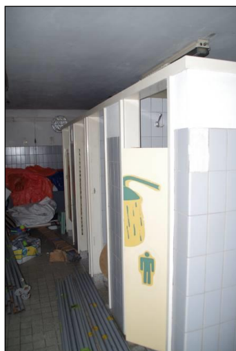
Sanitaire groep van gebouw nr. 826.
