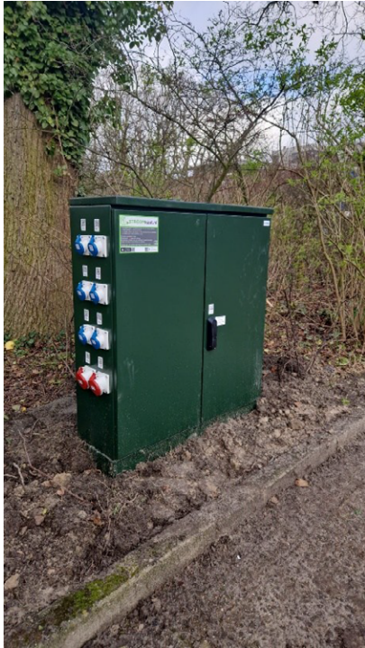
3. Eén van de elektrakasten op het terrein met aan de buitenzijde elektra-aansluitingen
