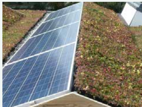
Combinatie van zonnepanelen en vegetatiedak.
