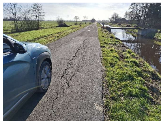
Dwarsonvlakheid en scheuring in asfalt op veengrond in Weststellingwerf.
