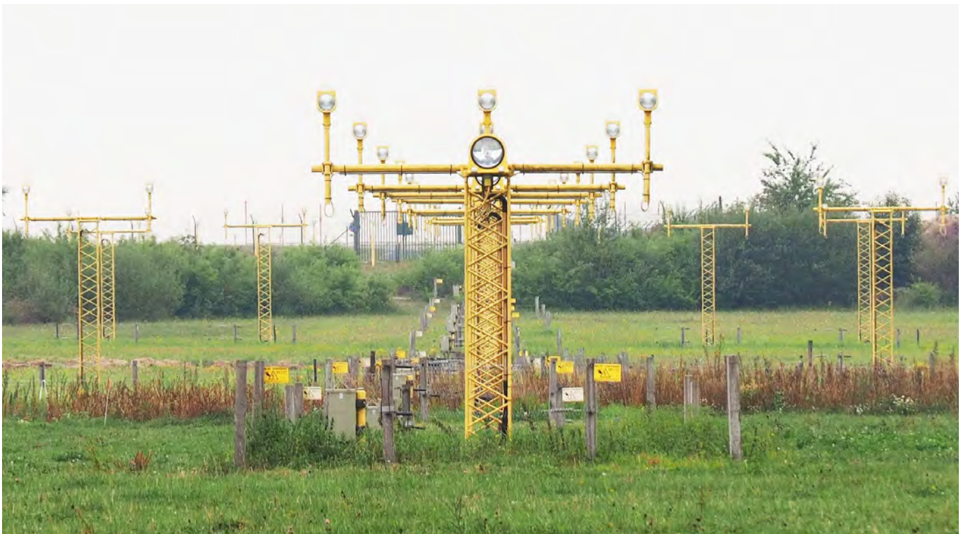
Lichtbakens bij de landingsbaan van vliegbasis Woensdrecht. Foto: Jac Leenaars, 2019. Bron: Fotogroep Zuidwesthoek.
