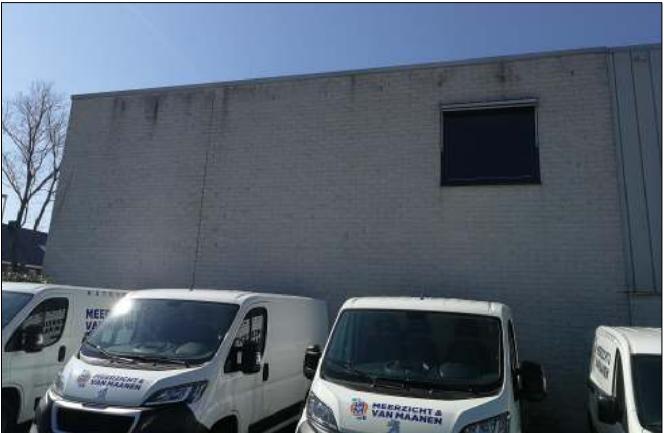
Figuur 3. De hier zichtbare gevel van het westelijke gebouw is voorzien van open stootvoegen. Gezien het onbeschutte karakter van deze gevel, met de afwezigheid van struiken en bomen, en de verlichting, maakt dit een vrij ongeschikte locatie voor dwergvleermuizen van het geslacht Pipistrellus .
