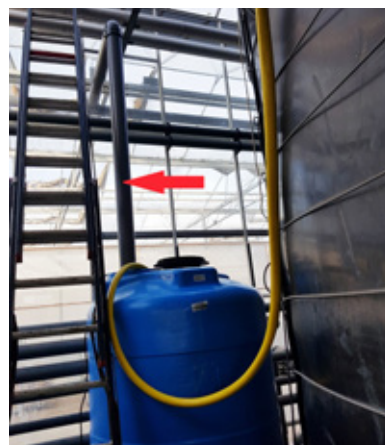
Condenswater afvoer via pvc-buizen naar pvc-opvangbak met dompelpomp naar dagvoorraad silo
