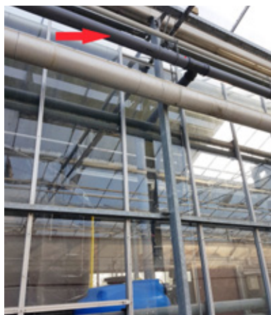
De verzamelleiding voert het condenswater af
