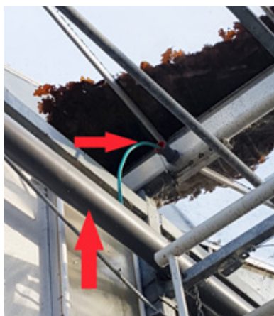
Condenswater afvoer via slangen naar verzamelleiding
