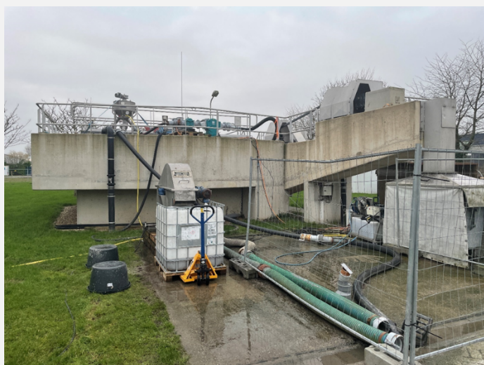
Figuur 19 Pilot Fijnzeefinstallatie op AWZI Zeewolde
