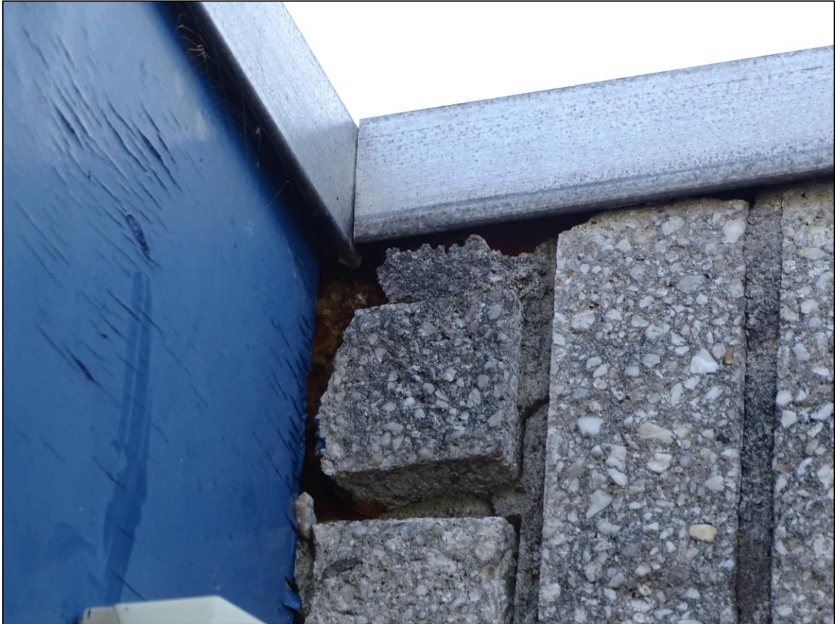
Figuur 4.5 Bij de boeidelen van het schoolgebouw zijn openingen aanwezig.
